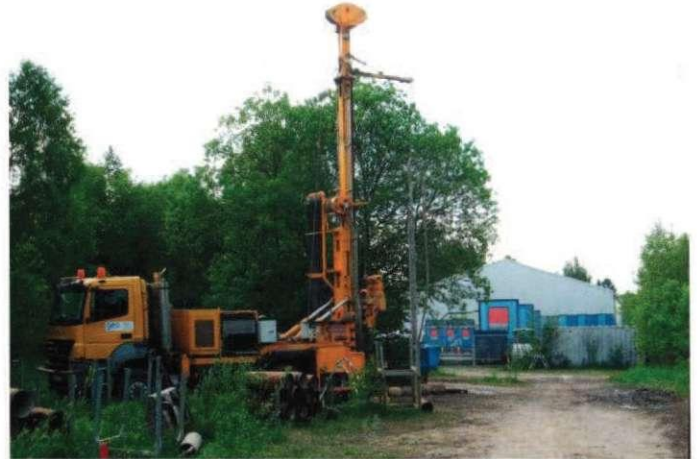
Bau eines Schluck- bzw. Förderbrunnens für die Sanierung des Grundwassers auf dem ehemaligen Schwellenwerk. Im Hintergrund das Gebäude mit den Pumpen und Filtereinrichtungen für das verseuchte Grundwasser.
