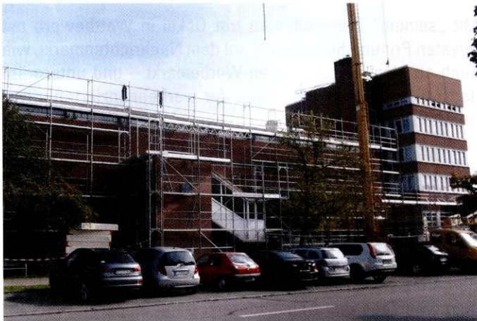
Rathaus mit Schwimmbad: nicht nur von außen renovierungsbedürftig.
